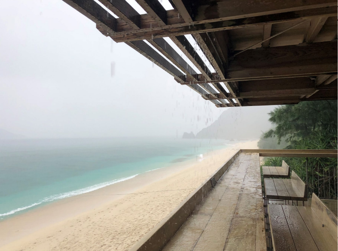
荒天時の状況(雨水・潮風の吹込み)
