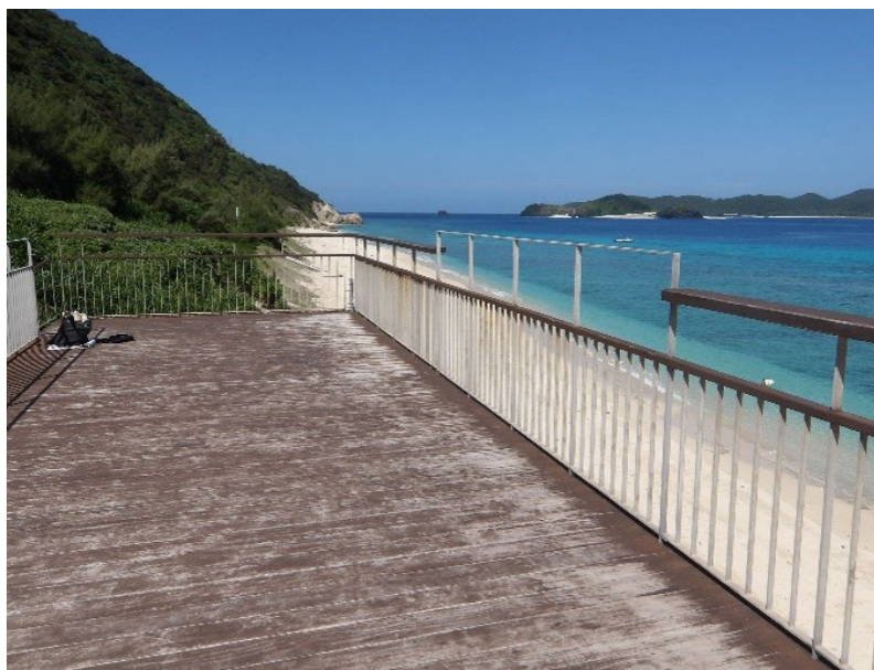
床面塗装の劣化
