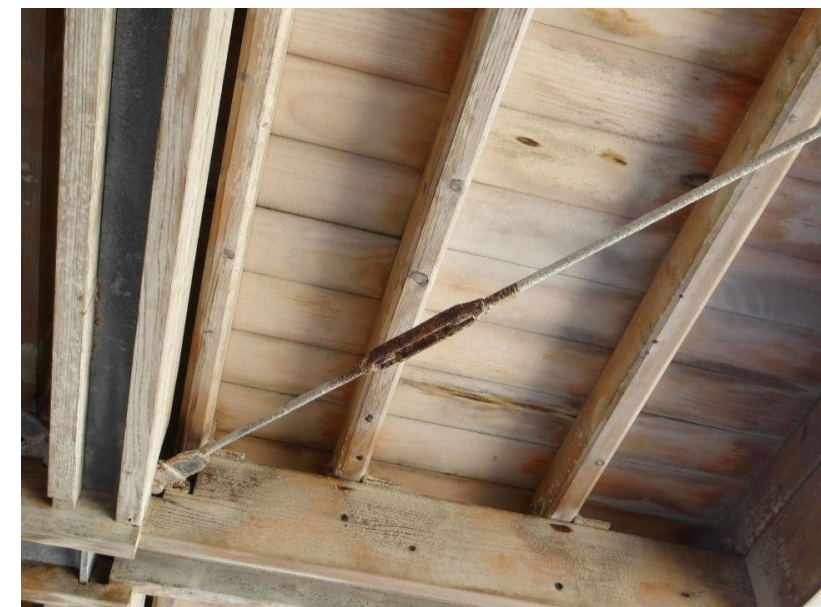
ブレース金物の錆
