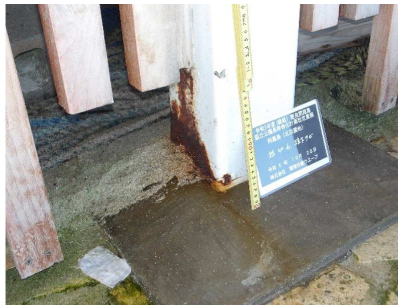
柱脚金物の錆
