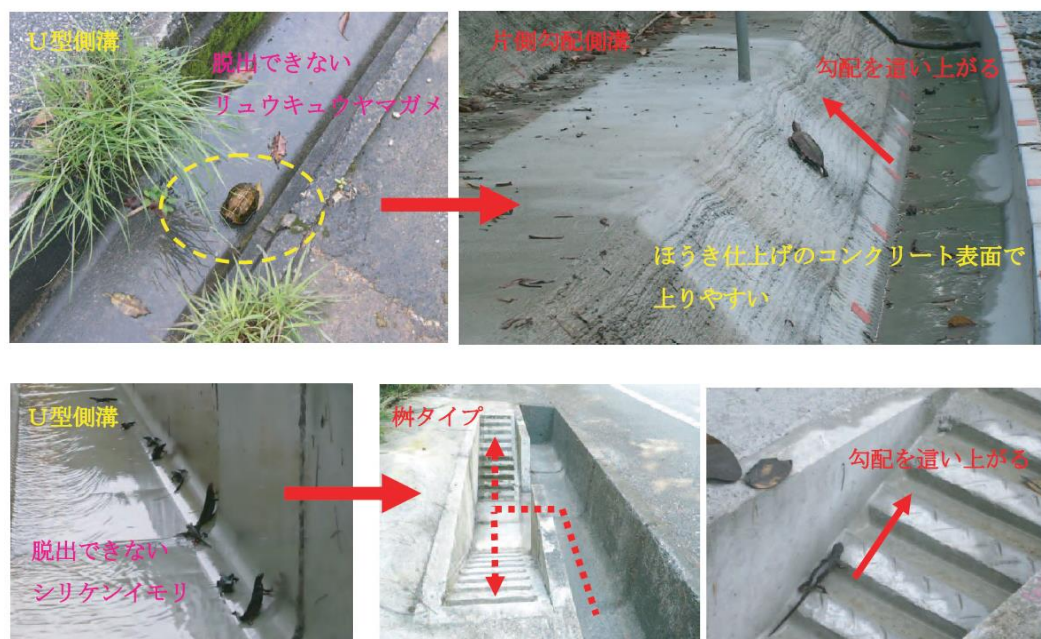
図 12. 片側勾配側溝及び柵タイプ側溝への改良。実際にリュウキュウヤマガメやシリケンイモリが勾配を這い上がることを確認。
