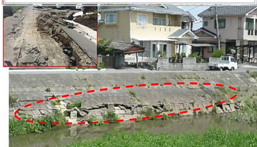
被災状況(平成28年4月15日撮影)
