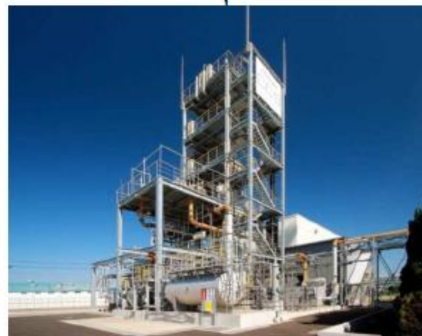
【燃焼後CO2分離回収パイロットプラント（東芝）】
