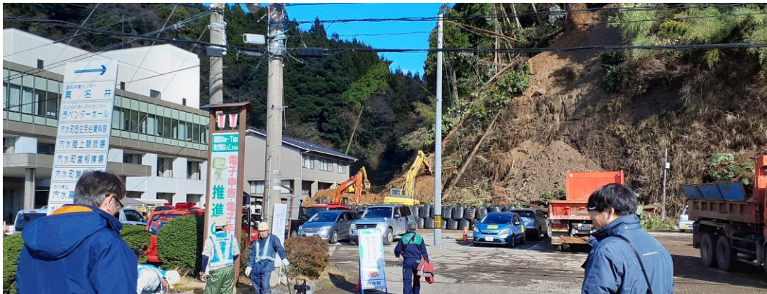
※左の建物は穴水町役場 玄関前の地面が変形し役場前の斜面が崩壊している (1月11日時点)
