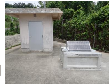
太陽光発電設備設置状況
