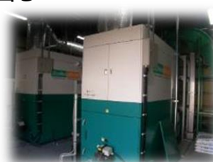
木質チップボイラ
