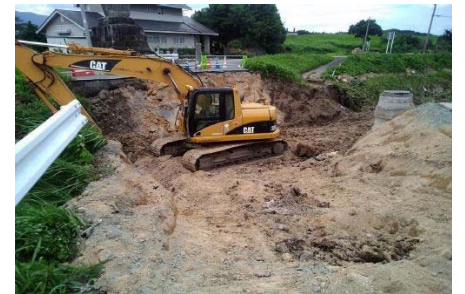
道路盛土の土砂流出 (朝倉市甘木地区長田 7/11)
