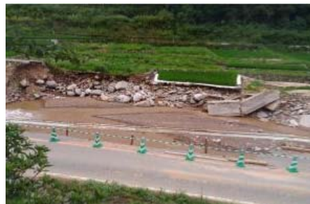
道路片側の崩落 (東峰村鼓の里付近 7/11)
