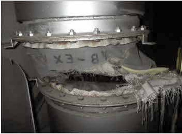
ダクト伸縮継手
