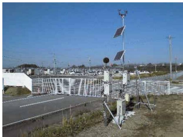
風向・風速計等の設置
