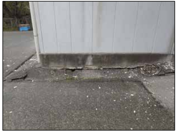
灰バンカ室付近地割れ、沈下
