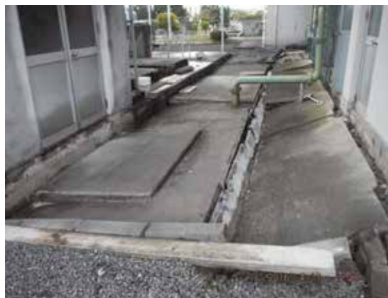
前処理棟・貯留槽間（陥没）
