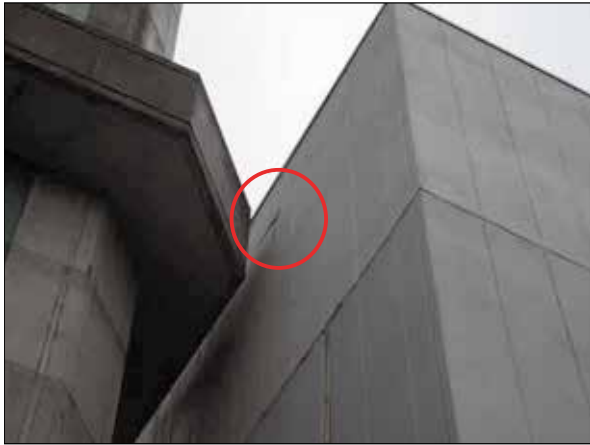
建屋外壁（煙突と接触し破損）
