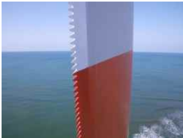
デバイス設置完了
