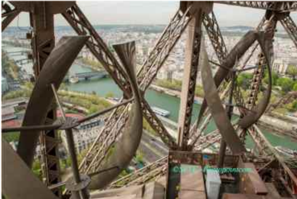
垂直軸風車が2機設置
