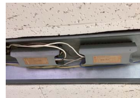
室内等で使用されている安定器
