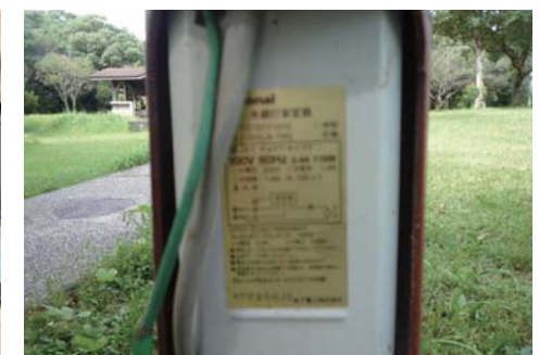
外灯等で使用されている安定器
