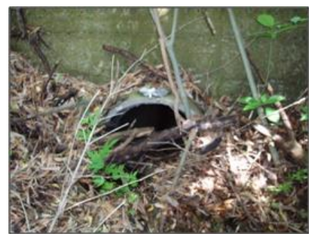
図 52. 閉塞したカルバート
