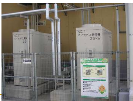
バイオガス発電機25kw
